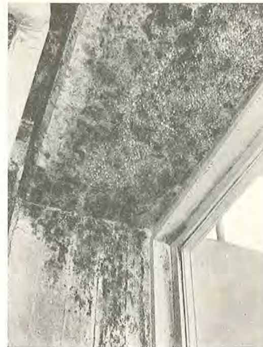
Fig. 37. Kuldebro over vindue i et lokale med høj luftfugtighed.
