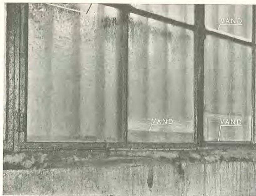
Fig. 35. Vinduer i et fabrikslokale med høj luftfugtighed.
