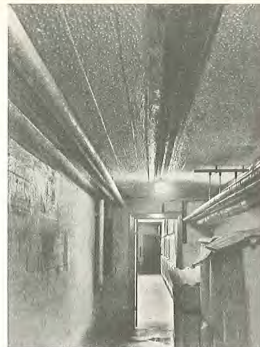
Fig. 36. Kældergang mellem to bygninger i en fabrik med luftbefugtningsanlæg.
